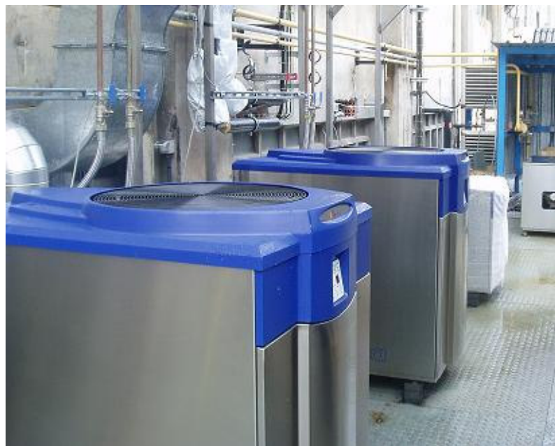
Planta de refrigeración y bomba de calor en Basauri
