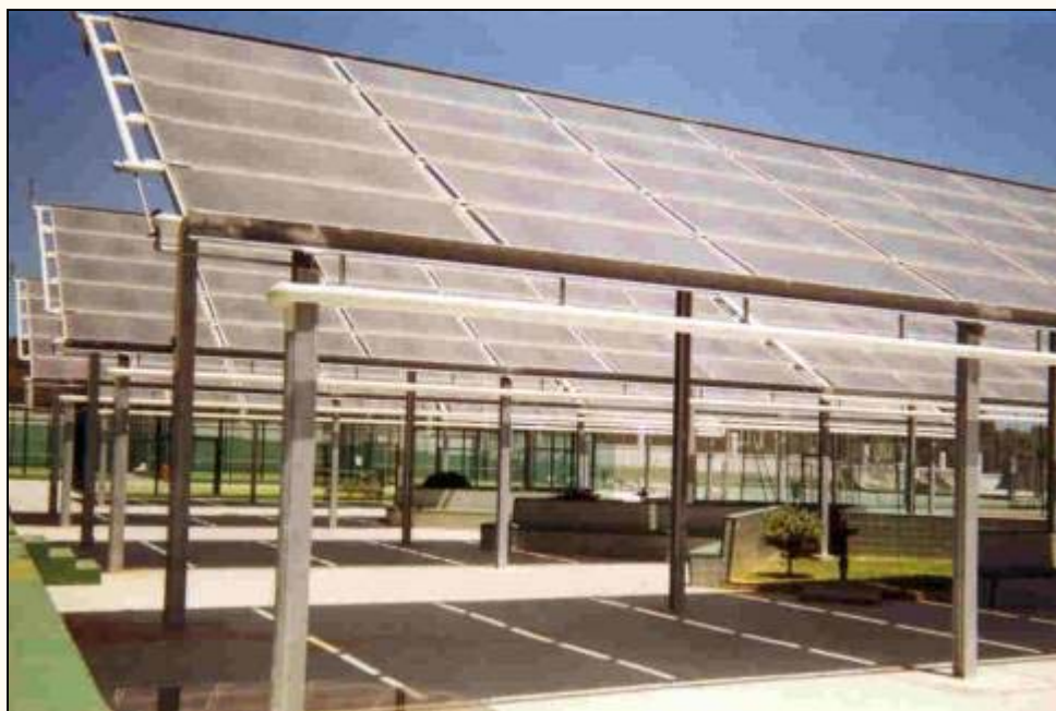
Detalle de las baterías de captadores en la instalación solar térmica
